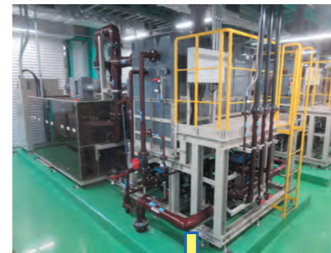
浸出水処理施設内に設置された「Eleca®」
